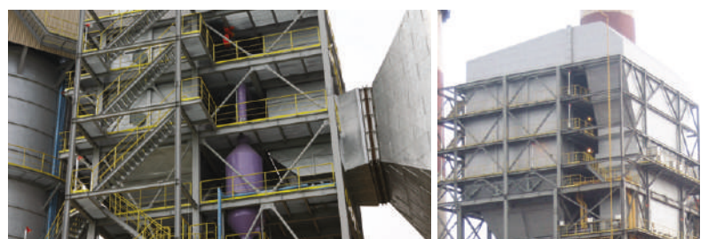
• 光阳镍铁厂脱硝设备
